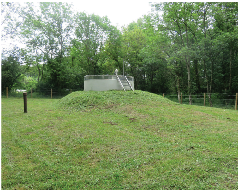
Puit de captage aux Cotilles
